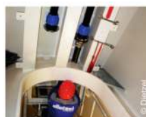
Verrohrung und Verschlauchung von Windkraftanlagen
